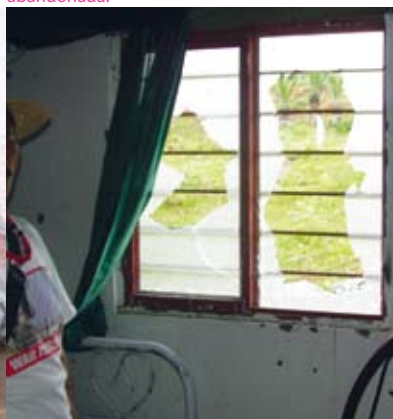
Afectación de una casa de la población civil con MUSE manipulada por niños que la encontraron abandonada.
